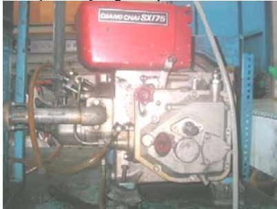
Gambar-3.2 Motor Bakar yang digunakan "Diesel Type Changchai SX 175".
