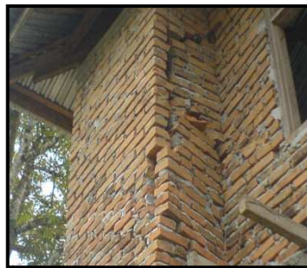
Gambar 1.1. Retak pada dinding tanpa kolom akibat beban gempa
